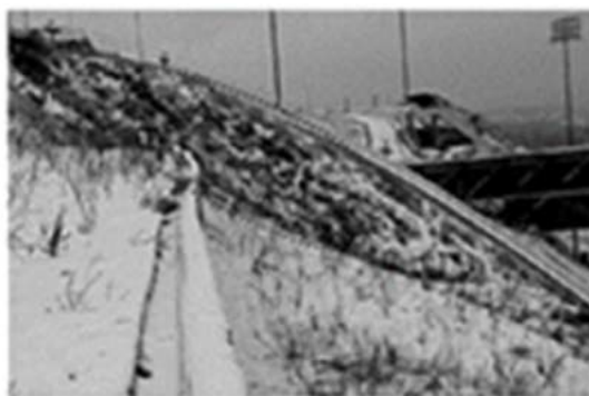
Рис. 1 Откосы склона, сложенные структурно-неустойчивыми грунтами.
