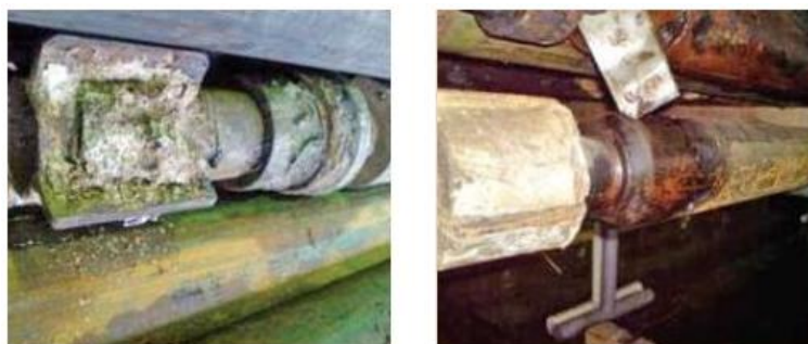
Рис. 1 Внешний вид практически растворенного и нового протектора
