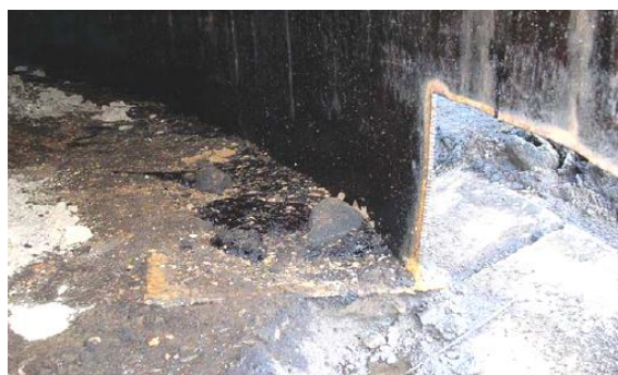
Рис. 2. Дефекты коррозии нижнего пояса и днища в комплексе с осадкой основания РВС 3 000 м 3
