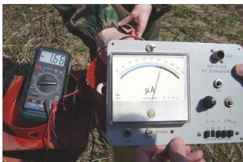
Рис. 5. Определение защитного потенциала и значение тока катодной защиты на 764 км магистрального нефтепровода «Александровское – Анжеро-Судженск»
