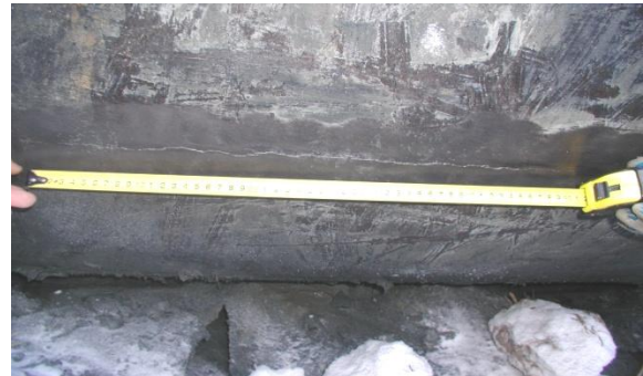
б) Стресс-коррозионные трещины
