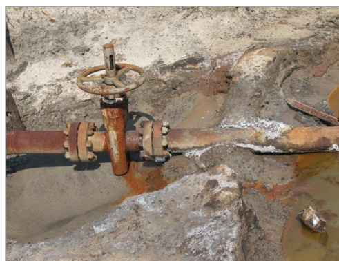
Рис. 4. Отложение солей на водоводе ВД, Александровский район, июнь 2005 г. (фото автора)
