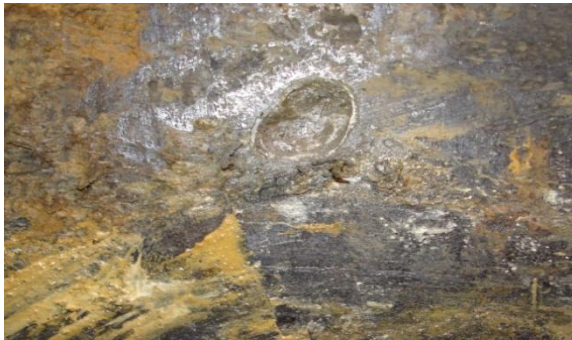
а) Коррозионные язвы
