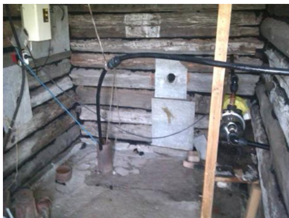
Рис.1 Павильон скважины «Геополлигонная» с погружным электронасосом
