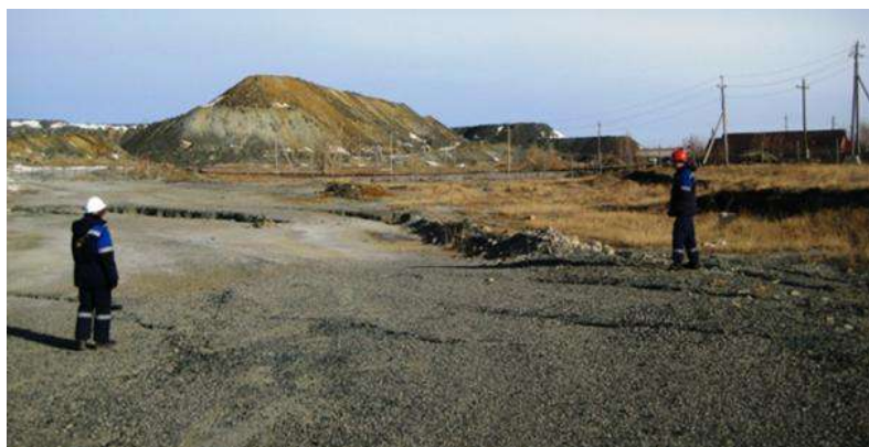
Рис.1 Северо-восточный борт Сибайского карьера (трещины, просадки) март 2017 г.
