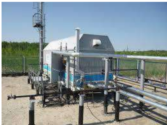
Рис. 3 Вакуумная компрессорная станция на Игольско-Таловом нефтяном месторождении
