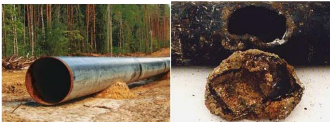
Abb. 1 Korrosionsschaden an Rohrleitung
