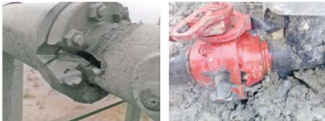
Рис. 1 Разрушение обвязки скважины в результате абразивного износа
