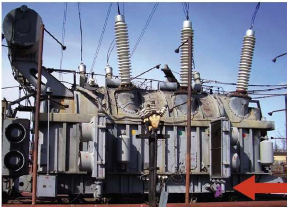
Рис. Выявленное повреждение трансформатора
