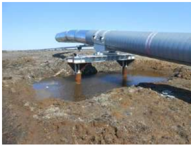
Рис. 3. Подтопление опор нефтепровода в результате строительной деятельности
