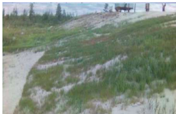
Рис. 8. Участок откоса насыпи через год после проведения восстановительных работ с использованием биоматов
