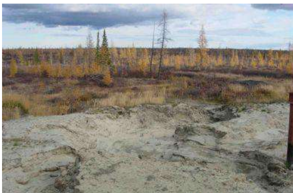
Рис. 7. Участок откоса насыпи до проведения восстановительных работ
